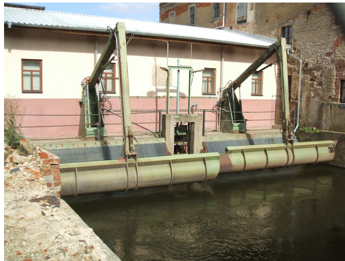
Abbildung 3.1: Klassischer Vertikalrechen mit Reiniger vor einer Wasserkraftanlage
